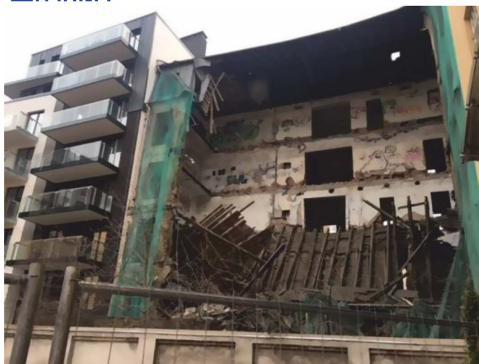
Daļējs ēkas nogruvums
